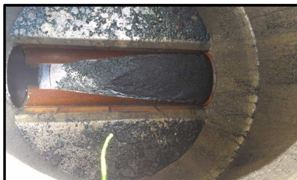
Ablagerungen im Kanal
